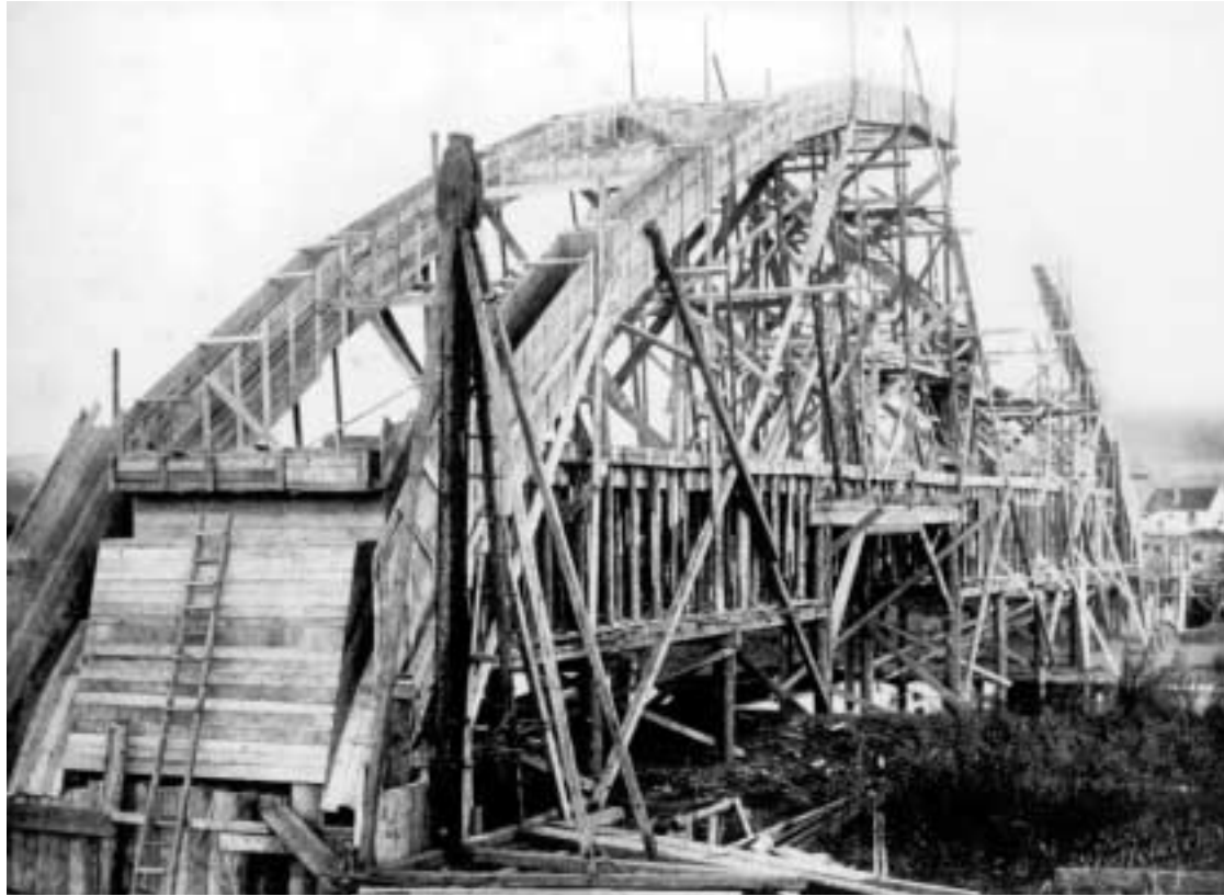
Lehrgerüst der Unterleiterbacher Mainbrücke von Westen, im Hintergrund das Fährhaus von Unterleiterbach (Foto J. Hospe, Staffelstein, Besitz Klaus Beyersdorf, Fa. O. Hauch, Coburg)
